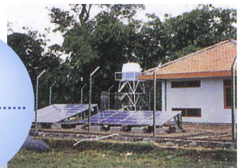
診療所用電源システム 1.6kW (インドネシア)
